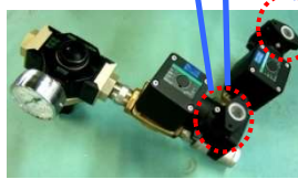
電磁弁ユニット (2系統)
